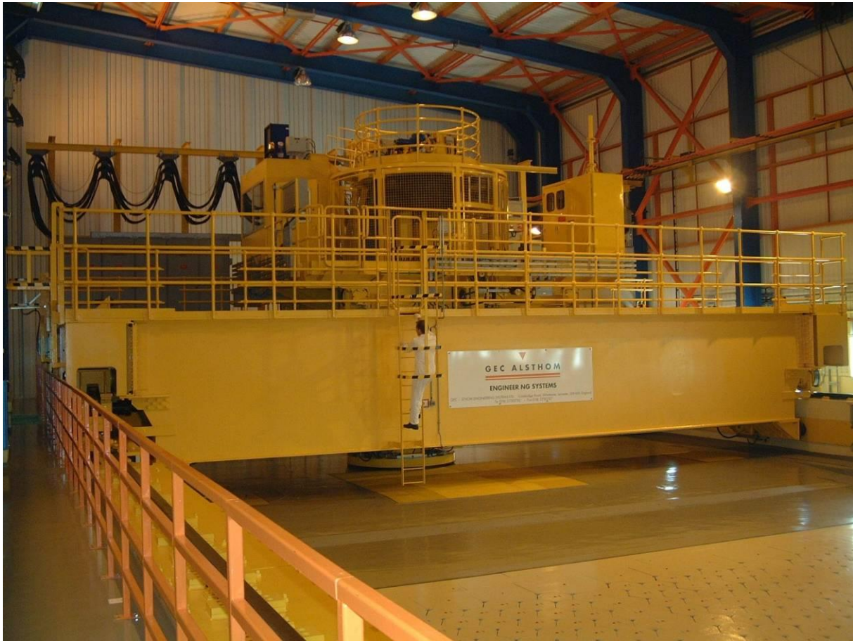
G.1 – 2. ábra Kiegészített Kazetták Átmeneti Tárolója: átrakógép
